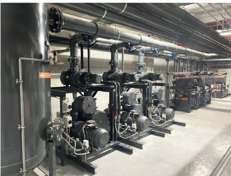
■ Abb. 3: Das zentrale Vakuumsystem von Paulig in Belgien.
