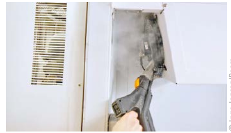
■ Abb. 4: Selbst empfindliche Technik wie den Verdampfer im Kühlhaus reinigt Sven Jansky mit dem Beam-Gerät besonders schonend.
