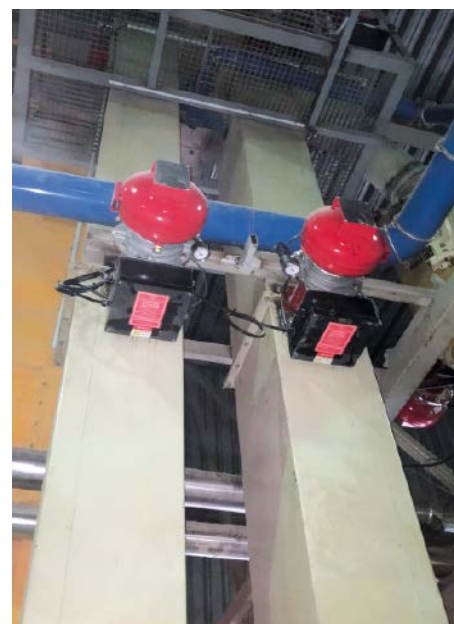
■ Abb. 2: Als chemische Entkopplung eingesetzt stoppt das IPD-System von BS&B die Ausbreitung einer möglichen Staubexplosion in den Schächten eines Becherelevators.
