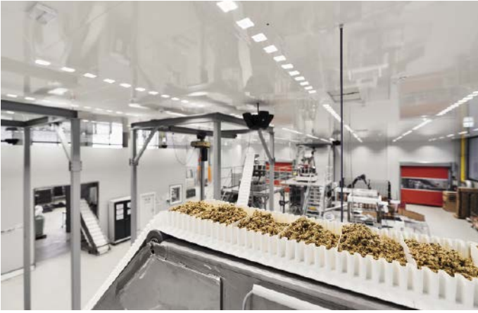
■ Abb. 2: Abseits der Öfen wurde die Hygienedecke in besonders reinigungsfreundlichem, pulverbeschichtetem Aluminium ausgeführt.
