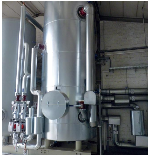
Die Wärmerückgewinnungsanlage bei der Henkell & Co. Sektkellerei.
