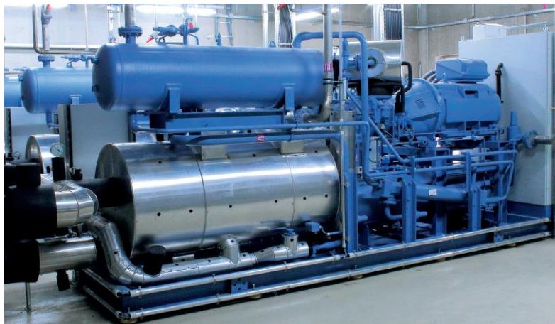
Die Energieeffizienz ist wesentlich auf die Drehzahlregelung des Schraubenverdichters mittels Frequenzumrichter zurückzuführen. Der ESEER-Wert (Europäische Jahresarbeitszahl: European seasonal energy efficiency ratio) des GEA Grasso Bluastrum beträgt durchschnittlich 8,0. © GEA
